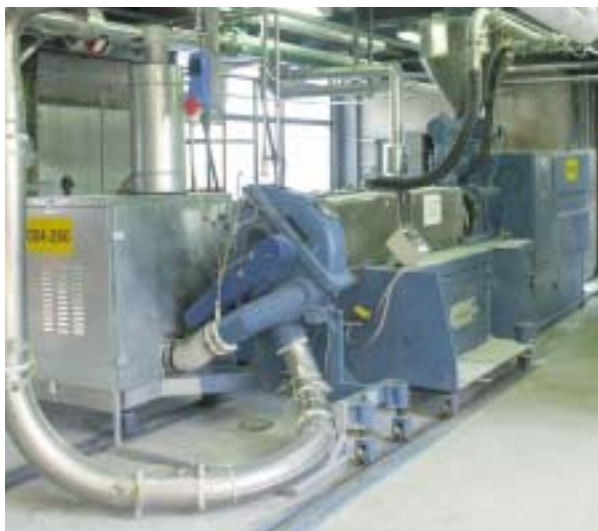
Transférée d'Italie, la production de granulés est aujourd'hui assurée par l'unité additifs plastique de Lauterbourg
