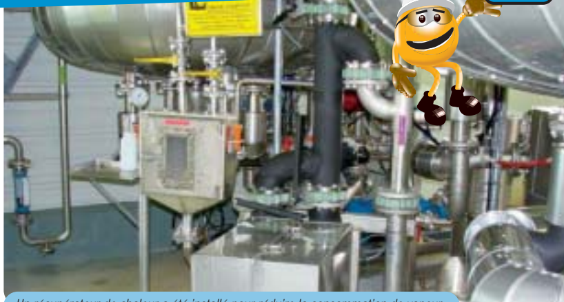
Un récupérateur de chaleur a été installé pour réduire la consommation de vapeur.
